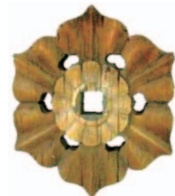
寺院屋根の側面の損傷した六葉
