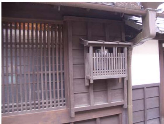
電気メーターを隠す細工
